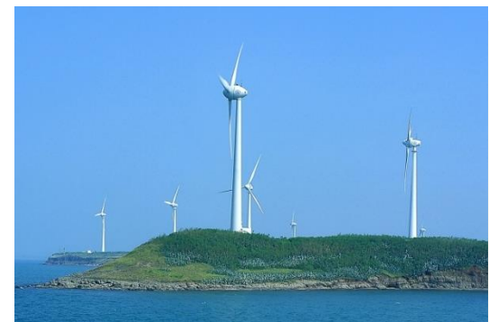
Chuntung, Penhu: 4.8 MW
